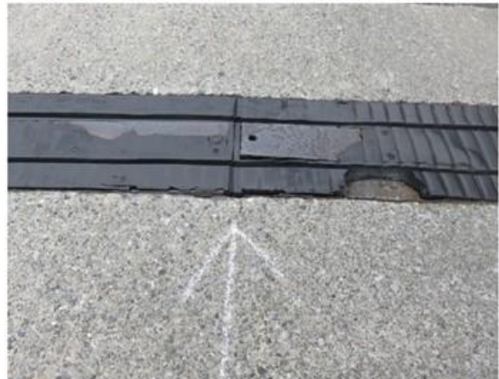
損傷状況(表面ゴムの剥れによる鉄板露出)
