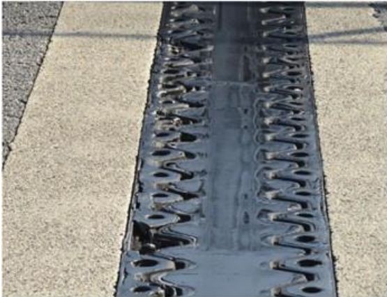
損傷状況(表面ゴムのき裂・剥れ)
