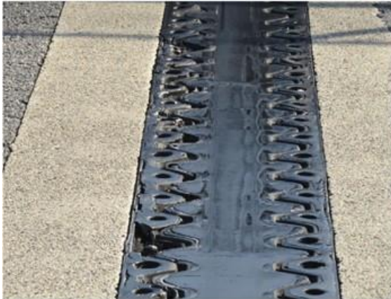
損傷状況(表面ゴムのき裂・剥れ)
