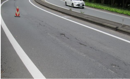
所沢 IC 現況舗装状況
