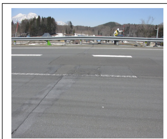
【舗装路面の損傷状況】
